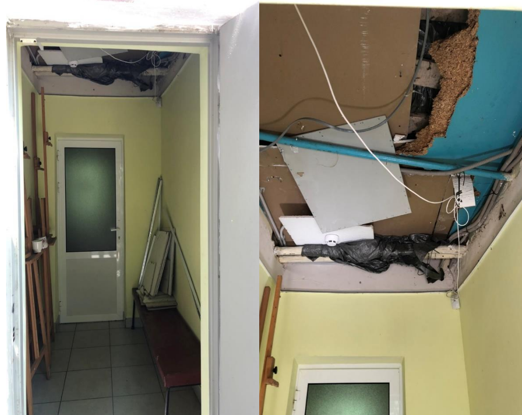
Бібліотека-філія №1 ЗК «Вінницька міська централізована бібліотечна система», м. Вінниця, проспект Коцюбинського, 49 стеля підвісна «Армстронг», система охорони та пожежної безпеки, система освітлення
