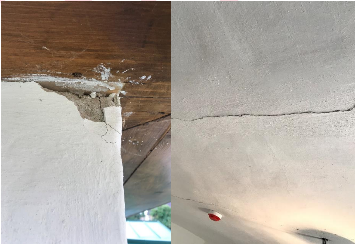
Вінницький літературно-меморіальний музей М.М.Коцюбинського, м. Вінниця, вул. І. Бевза, 15 пошкоджені 3 меморіальні будівлі музею та адмінприміщення
